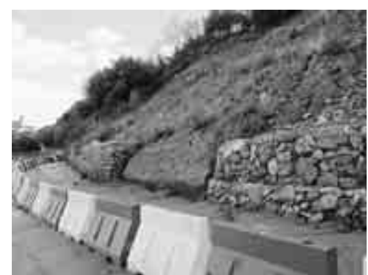
LA FRANA SUL SECONDO TORNANTE
