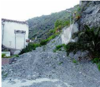
Il costone franato all'ingresso dell'abitato di Guidomandri
