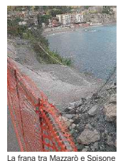
La frana tra Mazzarò e Spisone
