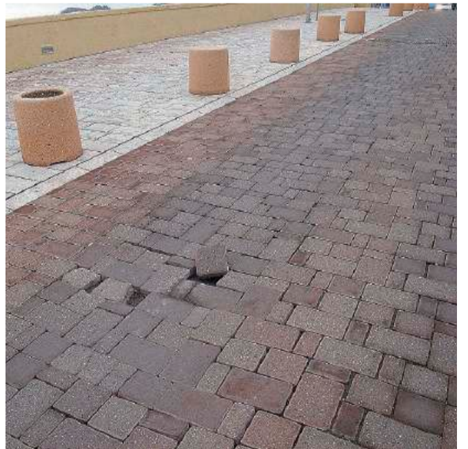
La pavimentazione in molti tratti presenta sconnessioni e avvallamenti
